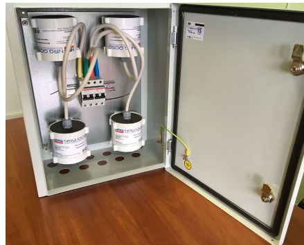
Blick auf den geöffneten Anschlusskasten für ein Stromnetz mit maximal 500 kW.
